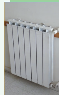
Figura 5.6. Ejemplo de un radiador por el que circula agua caliente.
