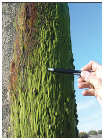
Figura 1.8. Biodeterioro de una estructura de hormigón.
