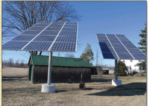
Paneles para aprovechar la energía solar.
